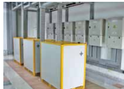
Drei SolarMax-Zentralwechselrichter wandeln den Strom der größten PV-Anlage der Kanarischen Inseln in netzkonformen Wechselstrom um.
