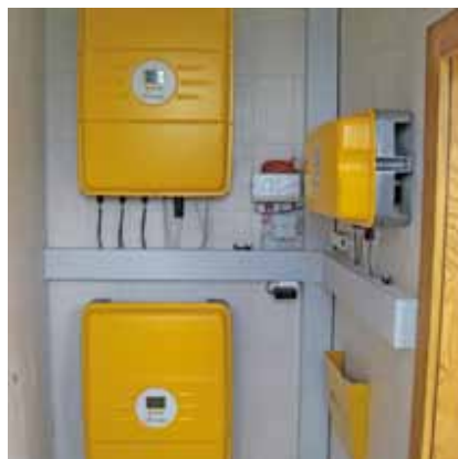
Voll und ganz überzeugt“ – Adrian Kottmann testet die neue SolarMax-MT-Serie in Ueberstorf.
