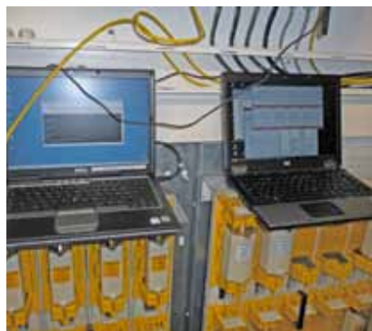
Komplett erfasst: Bei der Inbetriebnahme zeichnen Sputniks Servicetechniker sämtliche Daten der Pilotanlage auf.
