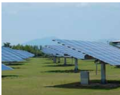
Größtes Nachführsystem der Lombardei: 92 Gestelle richten die Solarmodule zur Sonne aus.
